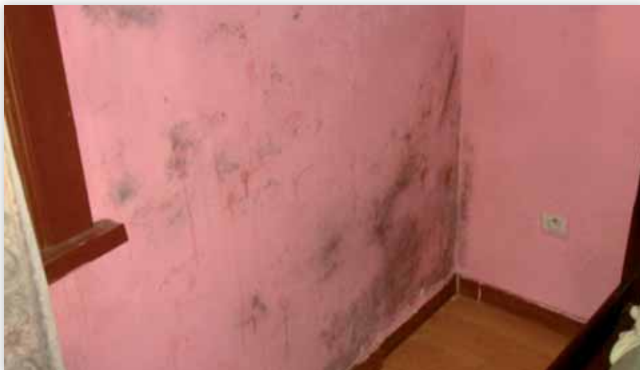
Des problèmes d'humidité, un vice caché parmi d'autres, sont souvent découverts à l'occasion d'une rénovation
